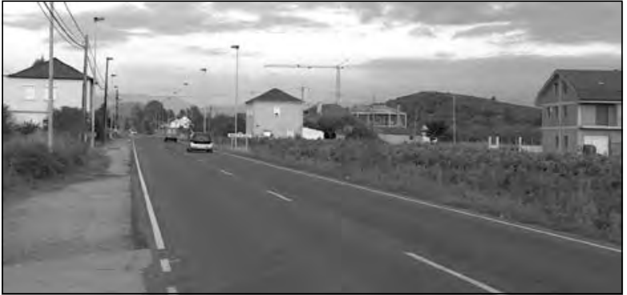
La imagen de la Avenida de Galicia en Magaz de Abajo sufrirá un cambio importante con las obras de remodelación.
